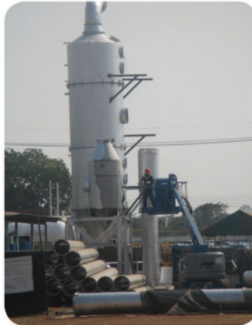
ระบบบำบัดมลพิษอากาศเตาชุบ
