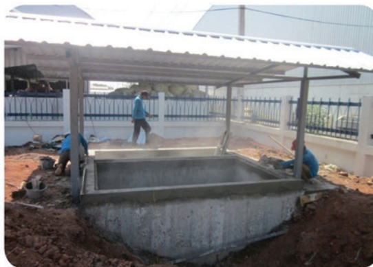
บ่อพักน้ำเสียรวม
