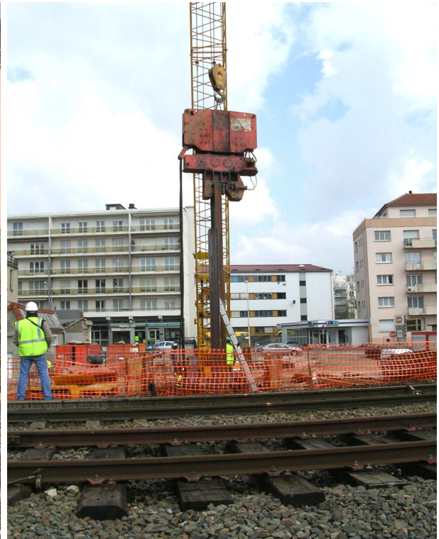
Figure 24 : Vesoul / Vibreur PTC20H et voies ferroviaires
