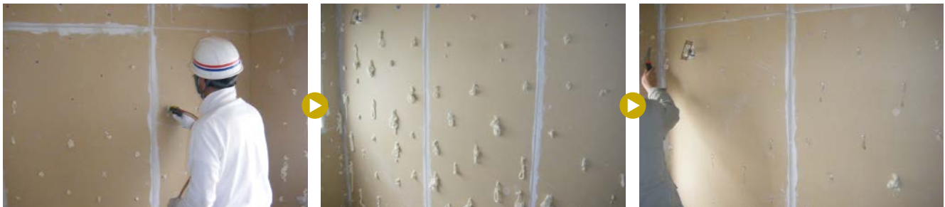
200mm～300mmピッチでボードに穴を開けインサルパックを注入 内部の隙間が十分に埋まると穴からインサルパックが吐出 吐出したインサルパックをカットして完了
