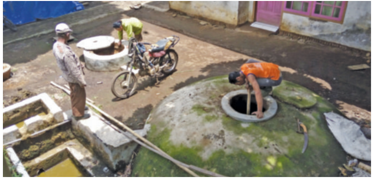
Unit pemrosesan biogas di Dusun Toyomerto, Desa Pesanggrahan Kota Batu.
