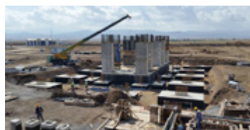
Kais 1,266MW 联合循环电厂 工程总包：韩国GS建设公司
