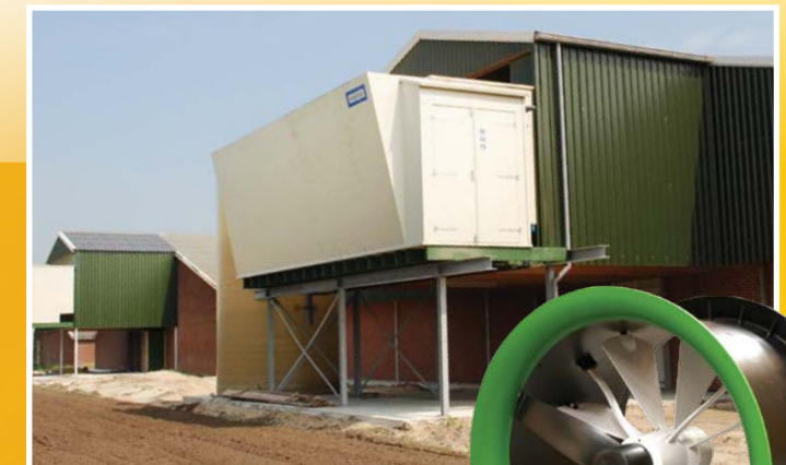
Luftreinigungs- und Luftfilteranlage
