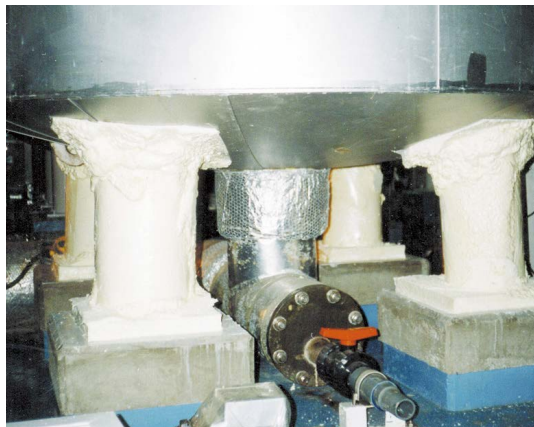
結露防止(海水タンクの結露防止)
