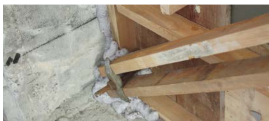
ノロ止め(コンクリート型枠の隙間にインサルシールを充てん)
