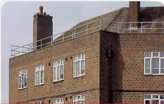
Roof Edge Protection
