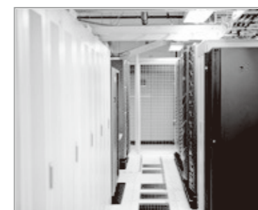
サーバールーム
