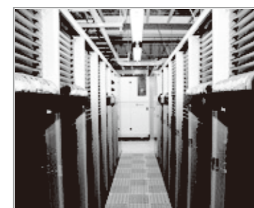
サーバールーム
