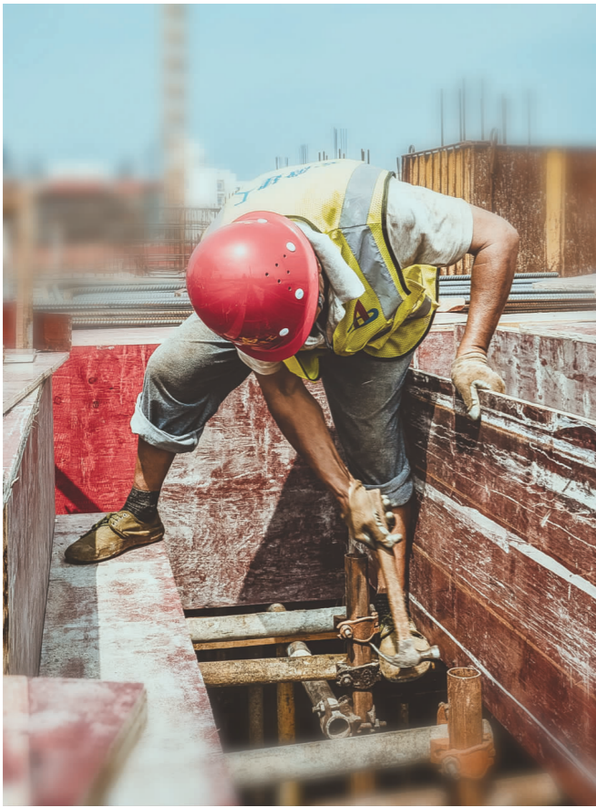
长丰县北城医院项目施工现场,一线施工人员依旧坚守各自岗位,战高温丝毫不松懈。
