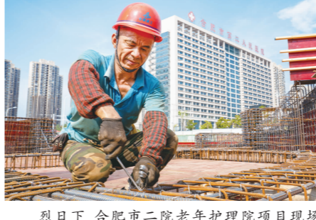
烈日下,合肥市二院老年护理院项目现场广大一线职工战高温斗酷暑,正在抢抓地下室顶板施工节点。
