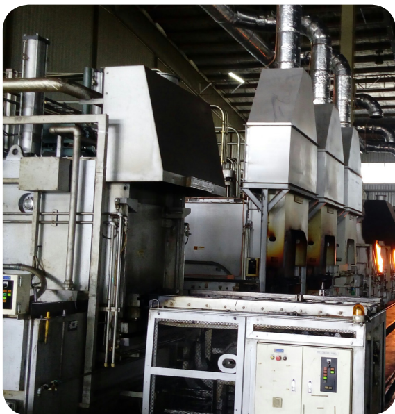
ระบบรวบรวมมลพิษอากาศเตาซุบ
