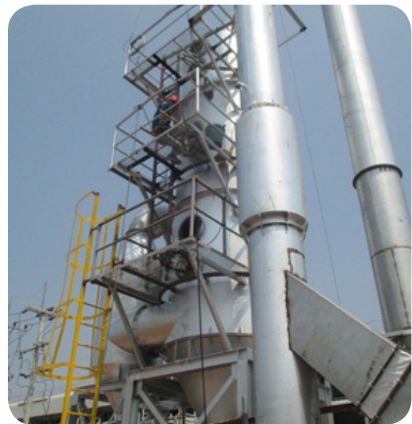
ระบบบำบัดมลพิษอากาศเตาซุบ
