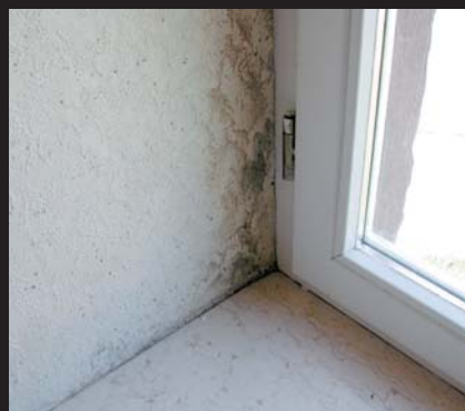
気密不足によるカビ発生の様子
