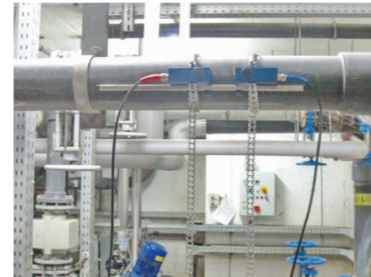
Thermal energy metering at Stadtwerke München
