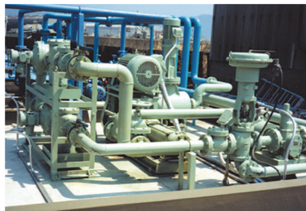
●陸上タンク基地設備ブレンダー制御器 Blender Controller unit at Land oil tank Base
