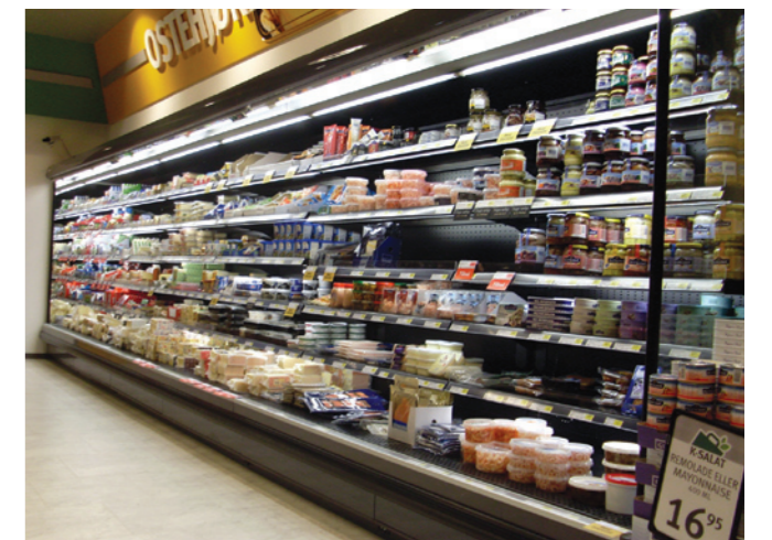
10. Imagen de un Supermercado en Dinamarca trabajando con CO 2 con tecnología de Frost-trol, S.A. y Green & Cool | Picture of supermarket in Denmark running with Frost-trol, S.A. and Green & Cool CO 2 technology | Image d'un supermarché au Danemark fonctionnant avec du CO 2 avec la technologie de Frost-trol, S.A et de Green & Cool
