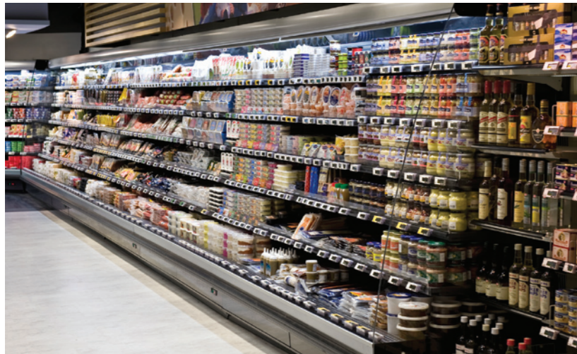
11. Imágenes de un Supermercado trabajando con CO 2 con tecnología de Frost-trol, S.A. y Green & Cool. | 11. Pictures of supermarket running with Frost-trol, S.A. and Green & Cool CO 2 technology | 11. Images d'un supermarché fonctionnant avec du CO 2 avec la technologie de Frost-trol, S.A et de Green & Cool.
